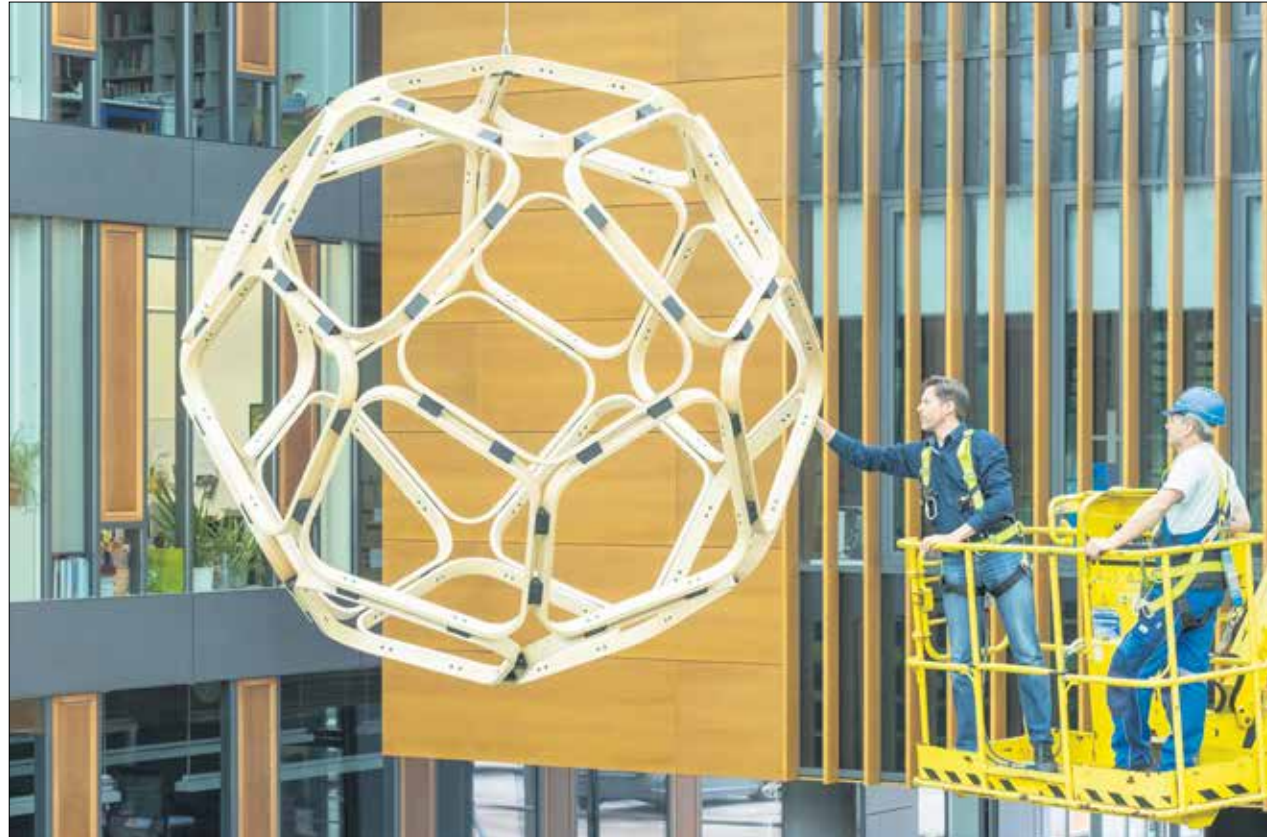
Prof. Lordick bei der abschließenden Begutachtung des installierten BenDit.
